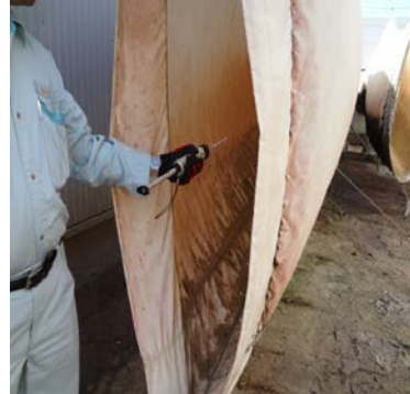
乾糞排気ダクト噴霧状況
